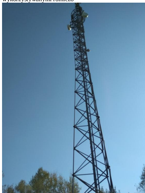
Fot. 16. Istniejąca stacja bazowa urządzeń telekomunikacyjnych
